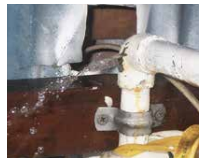
▲凍結による破裂は思わぬ所でも起きる
