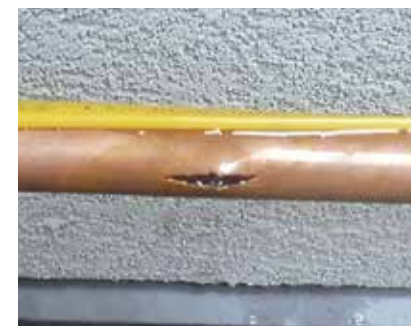
▲凍結により破裂した水道管
